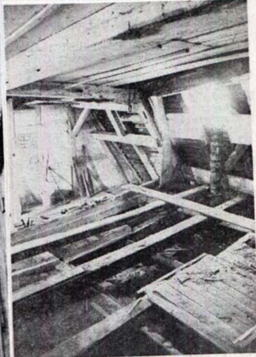
Problematisch ist die Renovierung des Dachstuhles in der Herberge zur Heimat. Durch einen Anbau aus dem 18. Jahrhundert verschob sich das Gebälk um mehrere Zentimeter.
